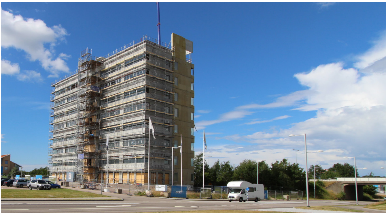
Det högsta huset på Berga i Helsingborg hade i juni nått sin fulla höjd. Floretten 4 beräknas vara färdig till årsskiftet.
